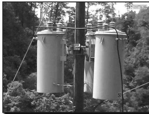
Figura 8.1 a). Banco trifásico
