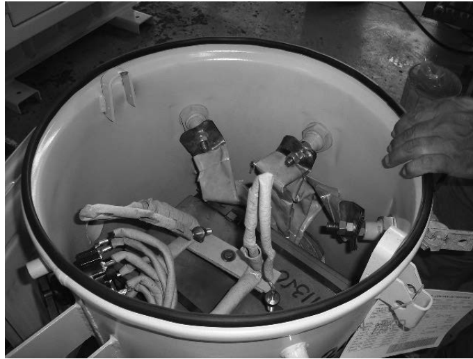
Figura 5.13. Conexión de terminales de bobina al cambiador de derivaciones
